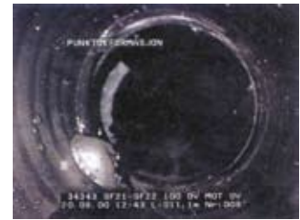
Dégradation de surface
