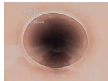
Ovalisation de canalisation
