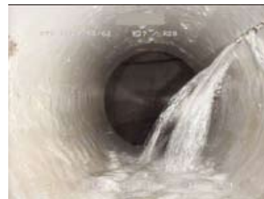
Pénétration d'eaux parasites
