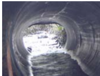
Déformation verticale et fissures longitudinales
