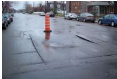
Affaissement de chaussée
