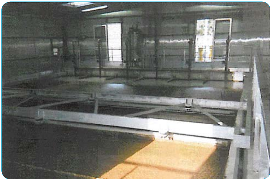
► Vue d'ensemble du flottateur de Dinan - Côtes d'Armor (photo extraite du Mémento du gestionnaire de l'alimentation en eau et de l'assainissement)
